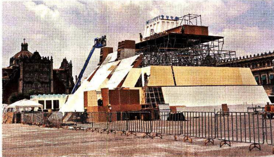
■ Las obras para levantar la maqueta en el Zócalo de la Ciudad de México iniciaron el 28 de julio.
