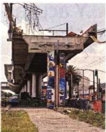
El 3 de mayo, una trabe de la Línea 12 colapsó entre la estación Olivos y Tezonco.
