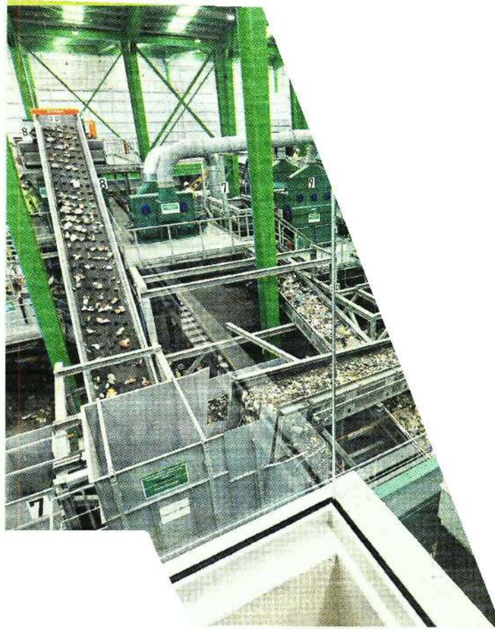
■ La nueva planta recibe cerca de 400 toneladas de orgánicos.
