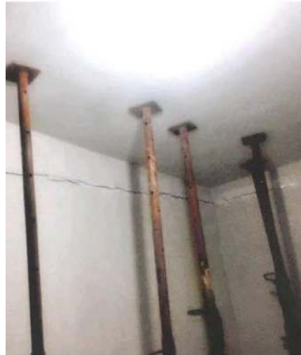
Los afectados exponen con detalle el grave daño que tienen los inmuebles y los riesgos de una tragedia en caso de temblor /FOTOS: CORTESÍA
