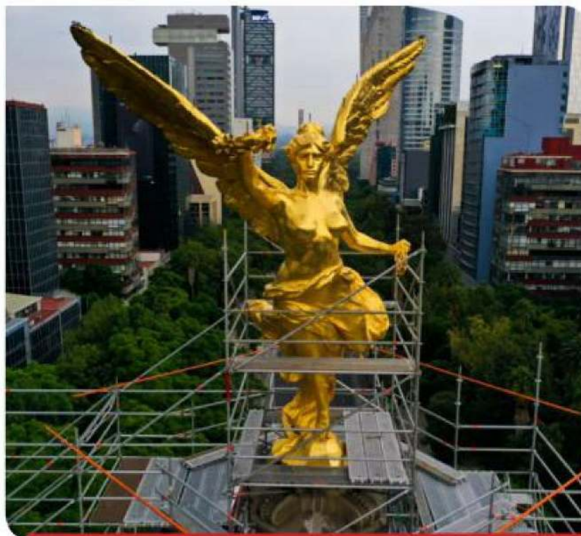
Los trabajos finales del Ángel de la Independencia están enfocados en la conservación de la fachada.
