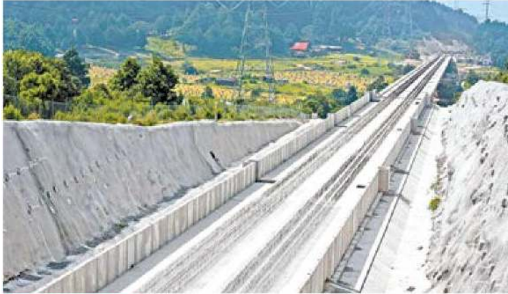
INFRAESTRUCTURA. Las obras del tren ya llevan más de seis años sin concluirse; conectará la CDMX con Toluca, en el EDOMEX.
