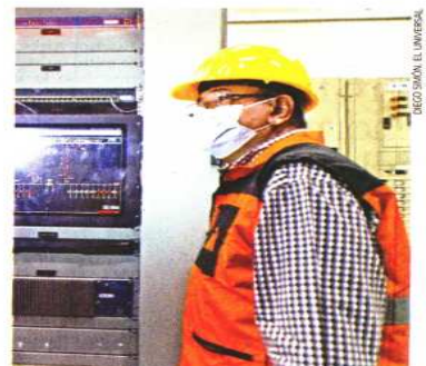
Personal del STC supervisa que todo funcione correctamente en el Puesto Central de Energía.
