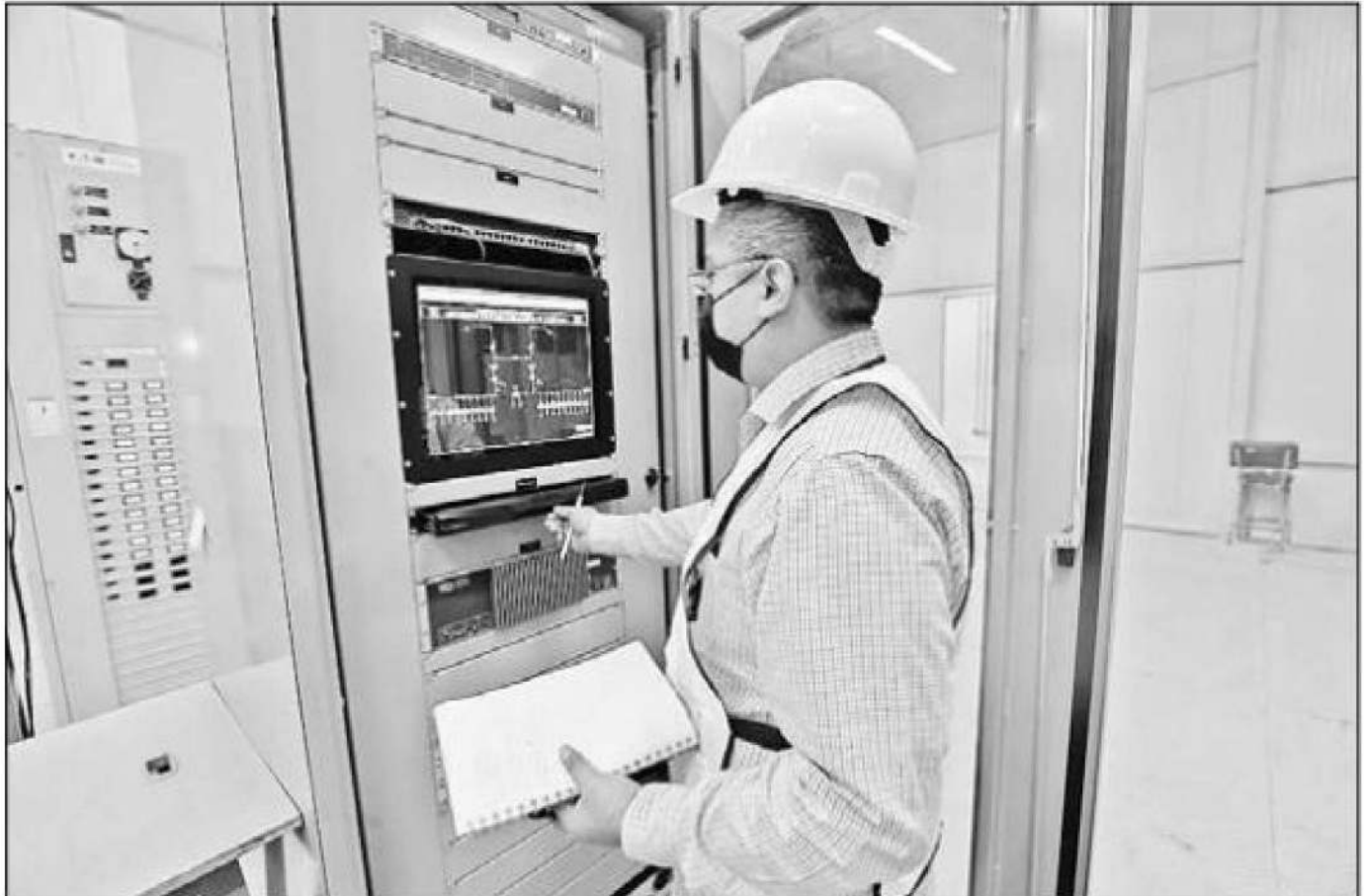
▲ Aspecto renovado del puesto central de control de energía emergente del Sistema de Transporte Colectivo instalado en el patio de la subestación de la calle Delicias 67. Foto Luis Castillo
