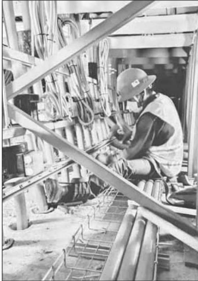
▲ Trabajadores del Sistema de Transporte Colectivo y de la Comisión Federal de Electricidad realizan las últimas pruebas del equipo del puesto central de control de energía emergente con la finalidad de restablecer el lunes 25 la operación de la línea 1. Foto La Jornada
