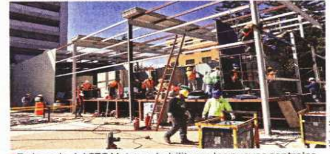
En la sede del STC Metro se habilitaron los nuevos controles.
