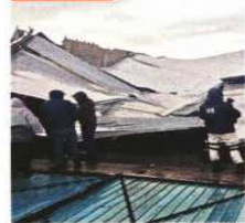
El granizo derribó la techumbre de una bodega.
