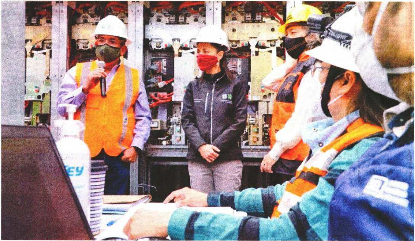
Claudia Sheinbaum recorrió las instalaciones del complejo Delicias, en la colonia Centro, donde se instaló el nuevo puesto de energía emergente.
