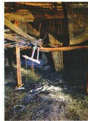
Aspectos de los daños en el puesto de control del Metro.
