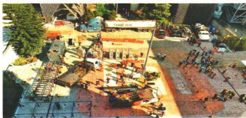
En el PCC emergente se colocaron 28 interruptores de alta tensión y lleva un avance de 30%.
