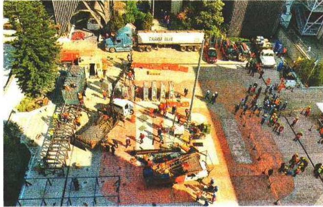
En el PCC emergente se colocaron 28 interruptores de alta tensión y lleva un avance de 30%.
