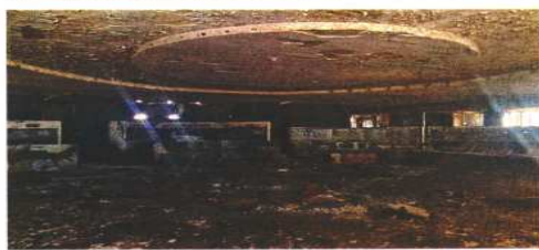
El 9 de enero, un incendio dañó el puesto de control del STC; siguen los peritajes.
