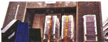
Foto: Cuartoscuro El pasado sábado la Subestación Buen Tono, ubicada en Delicias, colonia Centro, se incendió, dejando sin operar a 6 líneas.
