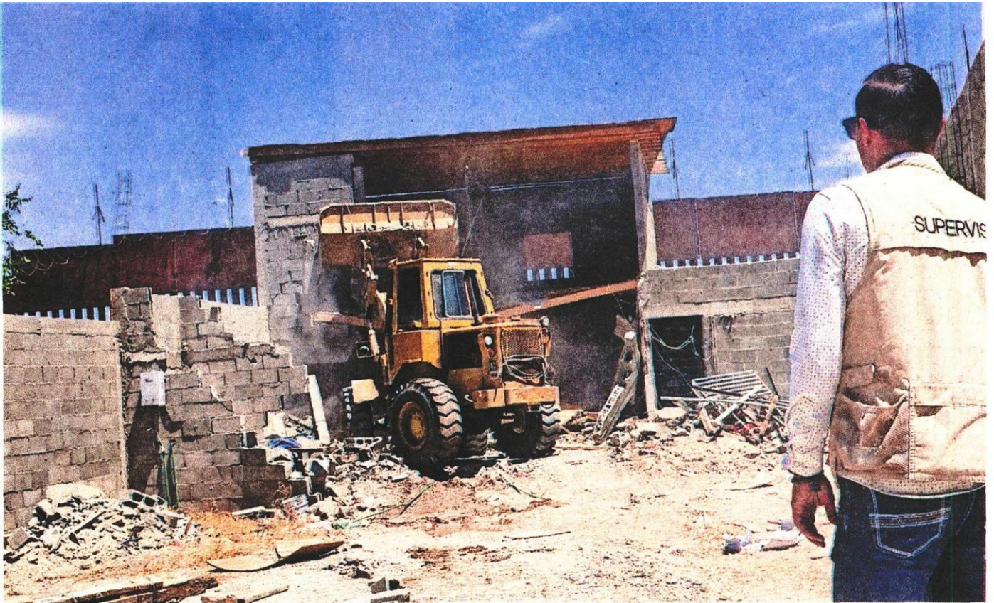
Autoridades advirtieron a Perla Mijares que tendrán que tirar parte de una barda, un cuarto que usan de bodega y otro en obra negra.
